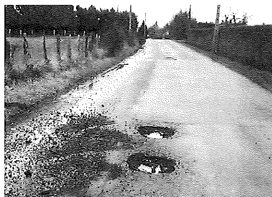
Dégradation de la voie
