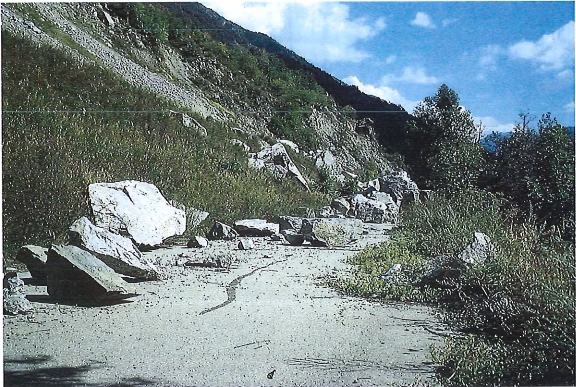
Photo 2. Chutes de blocs sur une route.
