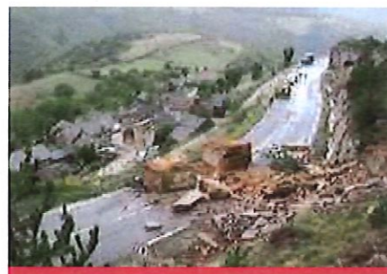
Éboulement de gros blocs sur route en Lozère. Dommage fonctionnel à structurel pour la voirie.
